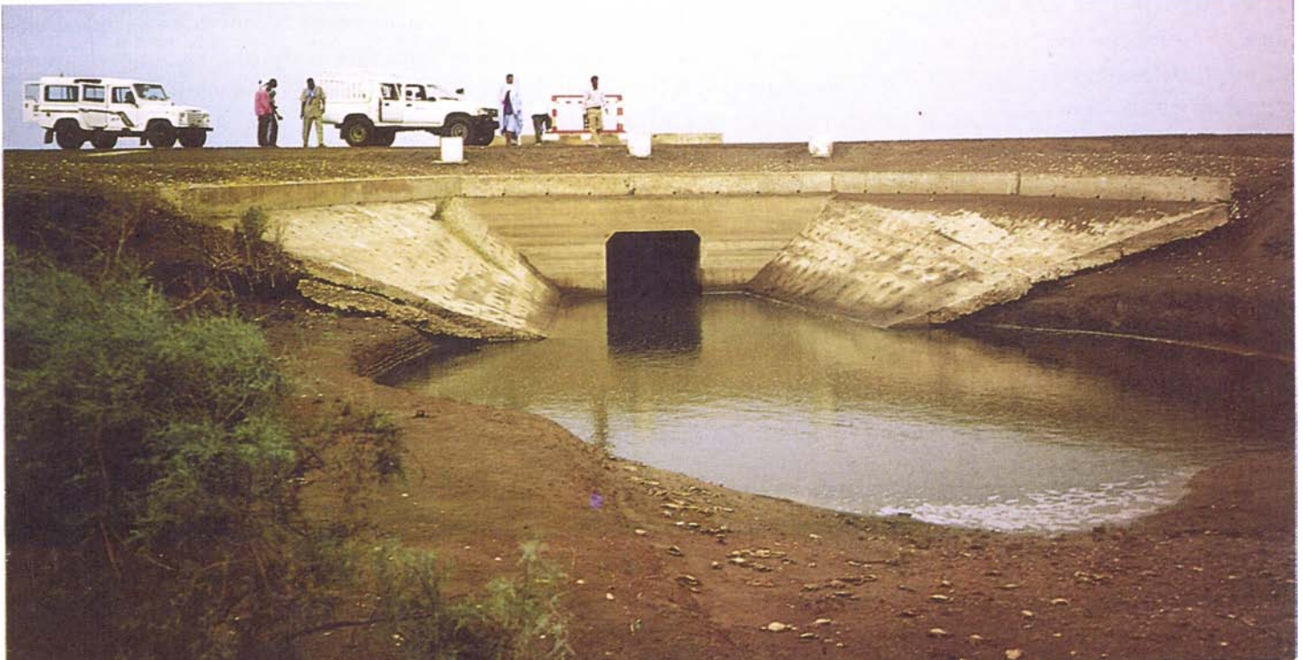
Photo n°3 : Ouvrage de Bell 1 (O.M.V.S.) et érosions en aval.
